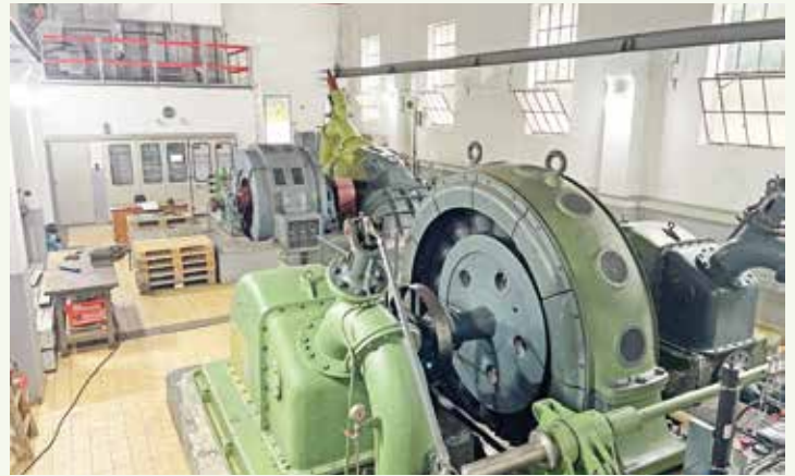
Neben dem Hauptkraftwerk in Großarmschlag (Bild) besichtigte man auch das Nebenkraftwerk in Hartmannsreit. Fotos: RegioEnergie.
