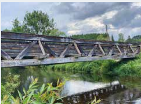
Die baufällige Gehwegbrücke über die Ilz ist derzeit gesperrt. Der Stadtrat hat sich jetzt für einen Abriss und Neubau des Brückenbauwerks entschieden (Foto: Pichlmeier).
